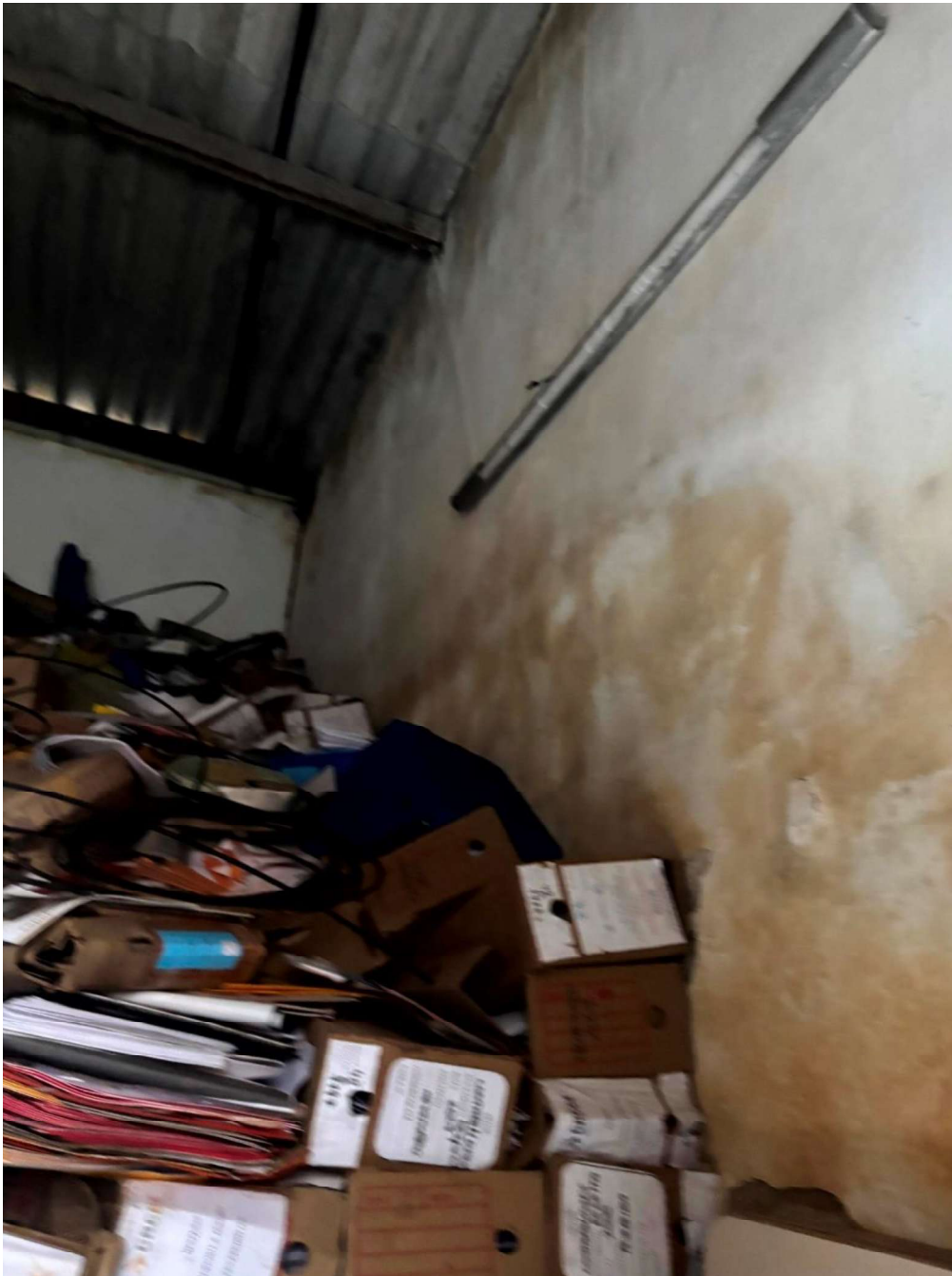
Infiltração na sala de documentos.
