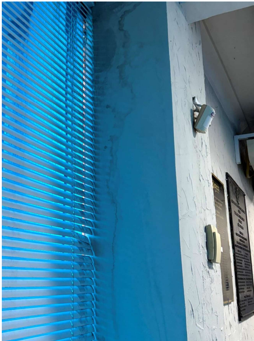
Infiltração na área da Recepção.
