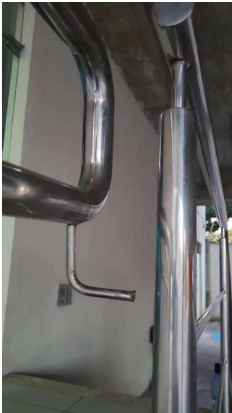
Guarda-corpo de acesso solto
