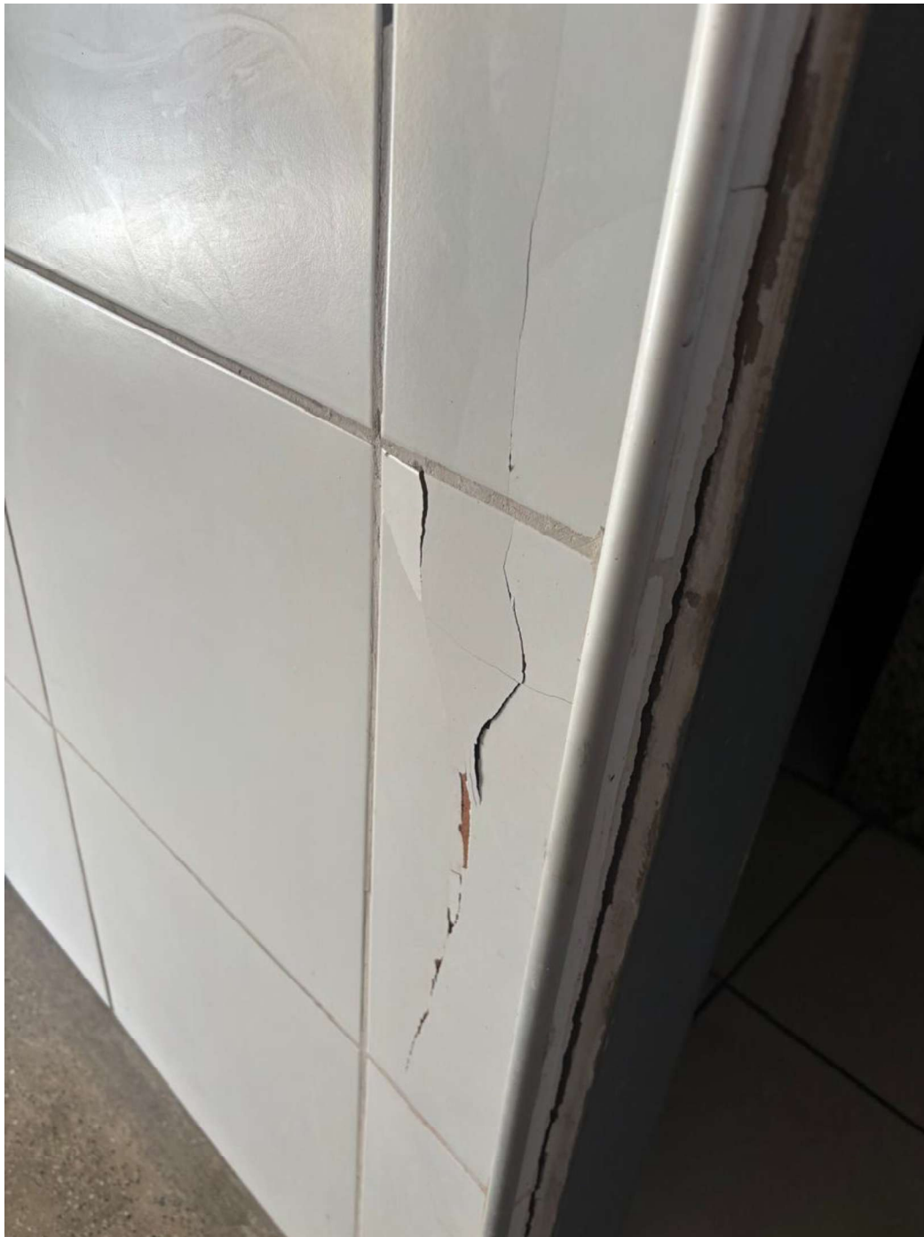
Laterais das portas do banheiro masculino com rachaduras.
